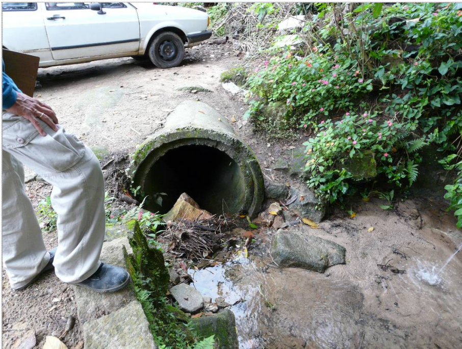
Foto CA-CG-01-04: Sistema de drenagem precário e obstruído. Executar limpeza e instalação de canaletas de direcionamento do fluxo.
