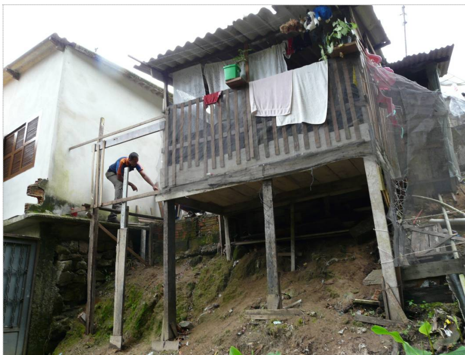
Foto CA-CB-03-05: Moradias localizadas nos taludes marginais do canal de drenagem do setor, sujeitas ao risco de erosão e solapamento. Sugere-se a proteção superficial do talude.
