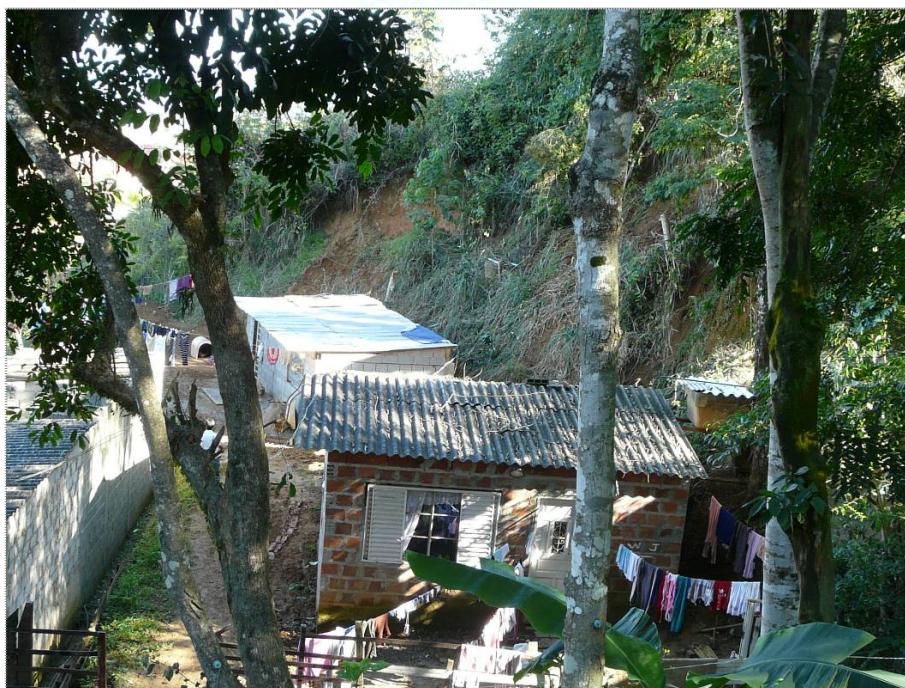
Foto CA-CL-01-02: Moradias muito próximas à base do talude de corte, que apresenta cicatrizes de escorregamentos.
