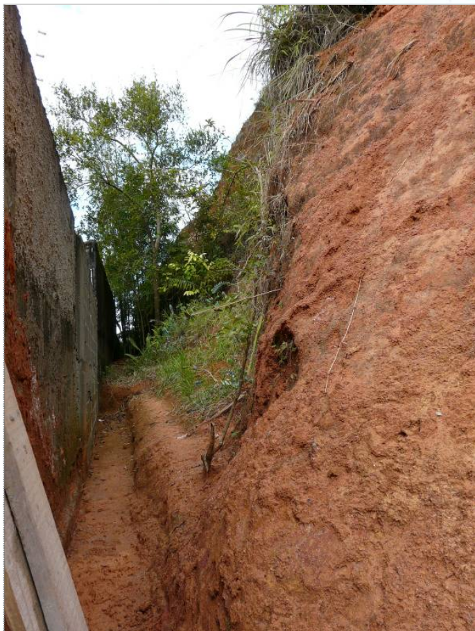
Foto CA- MS/JF -01-02: Proximidade da moradia ao talude de corte. A concentração do escoamento superficial no muro dos fundos da residência compromete sua estrutura.
