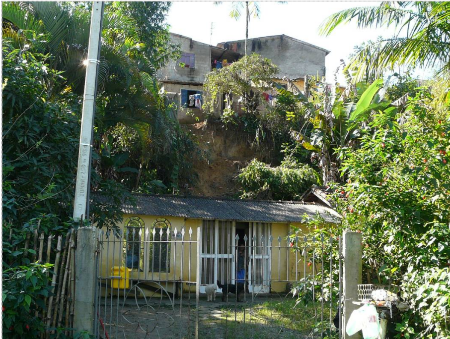
Foto CA-JA-07-01: Observar cicatriz de escorregamento em talude de corte. Moradias muito próximas à base e ao topo do talude.
