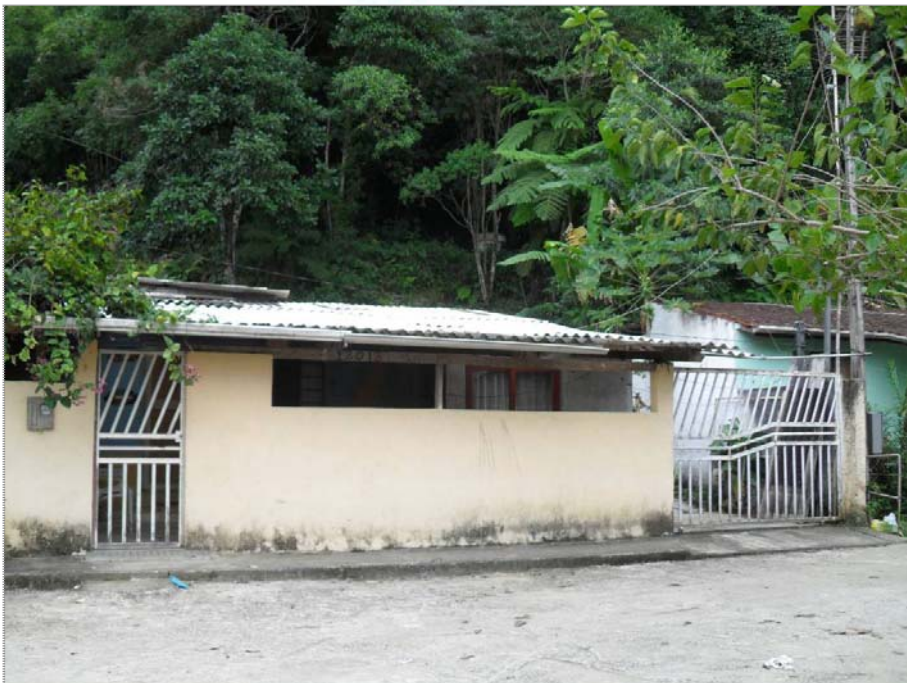
Foto CA-CO-01-04: Na porção de base da encosta natural ao fundo das casas foram observadas cicatrizes de pequenos escorregamentos.
