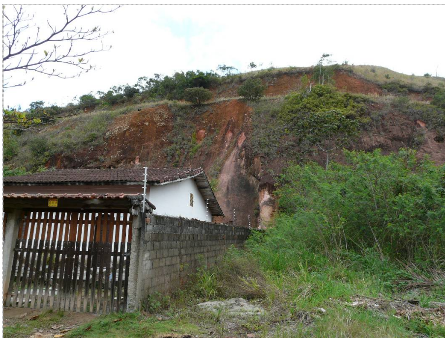
Foto CA- MS/JF -01-03: Moradia próxima ao talude de corte com presença de cicatrizes de escorregamentos.
