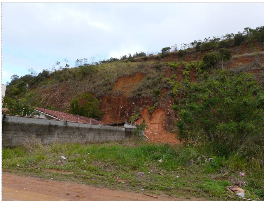
Foto CA- MS/JF -01-01: Observar altura e inclinação da encosta e a proximidade da moradia à base do talude.
