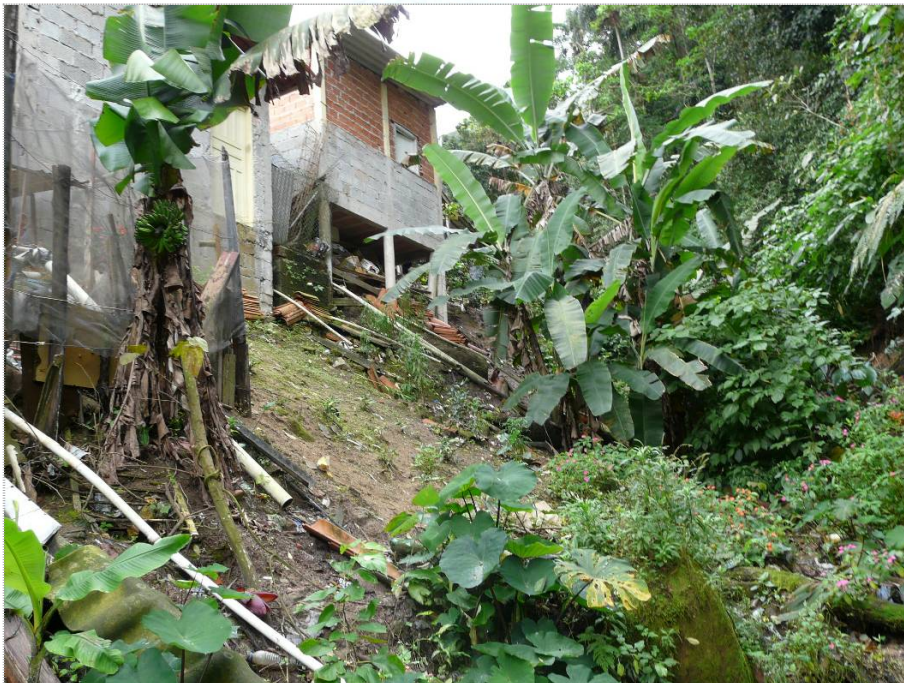
Foto CA-CB-03-04: Drenagem natural recebendo lançamento de esgoto e águas servidas em superfície, bem como lixo, entulho e restos vegetais. Presença de bananeiras no leito do canal.
