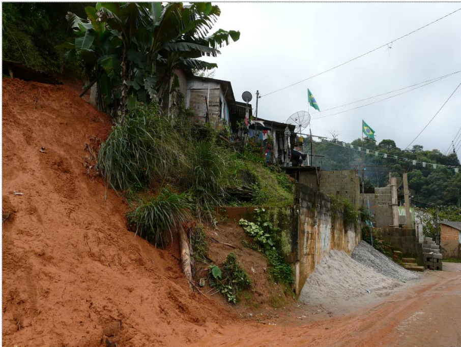
Foto CA-CG-03-02: Moradias de baixo padrão construtivo. Remobilização de material decorrente de escorregamento.
