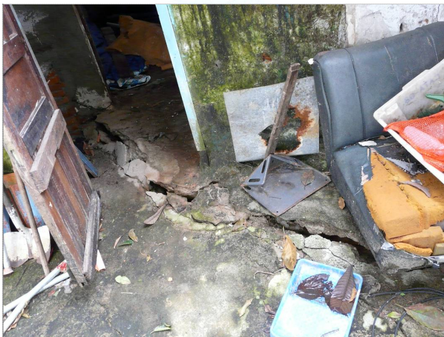
Foto CA-CB-03-02: Trincas no terreno, indicando a movimentação do terreno no topo do talude de corte. Sugere-se a demolição deste cômodo.
