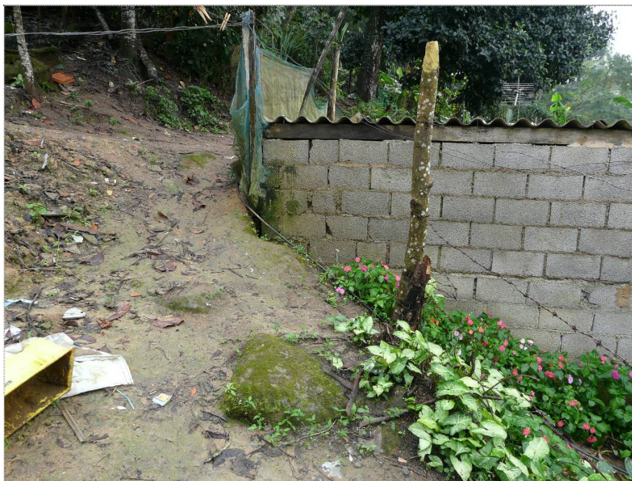
Foto CA-OL-01-03: Moradia com alto grau de risco pela proximidade do talude de corte. Executar contenção localizada para mitigação desta condição.
