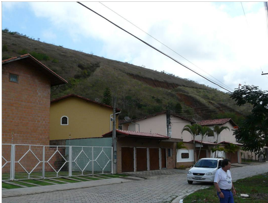
Foto CA-PR-03-03: Trincas e degraus de abatimento de grande extensão indicando o alto grau de risco de escorregamento no topo do talude. Observar bom padrão construtivo das moradias.
