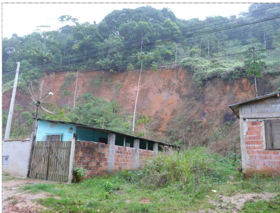
Foto CA-ST-01-01: Moradia de alvenaria com médio padrão construtiva na base da encosta natural e taludes de corte muito altos e íngremes.
