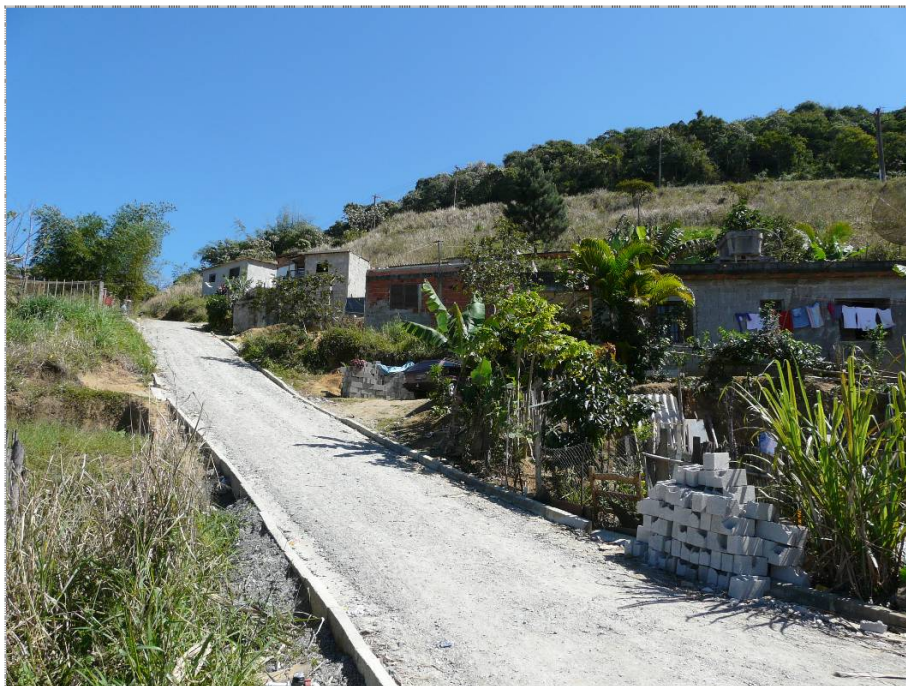
Foto CA-SR-01-01: Vista geral do setor que apresenta grau de risco médio. Rua em processo de pavimentação.
