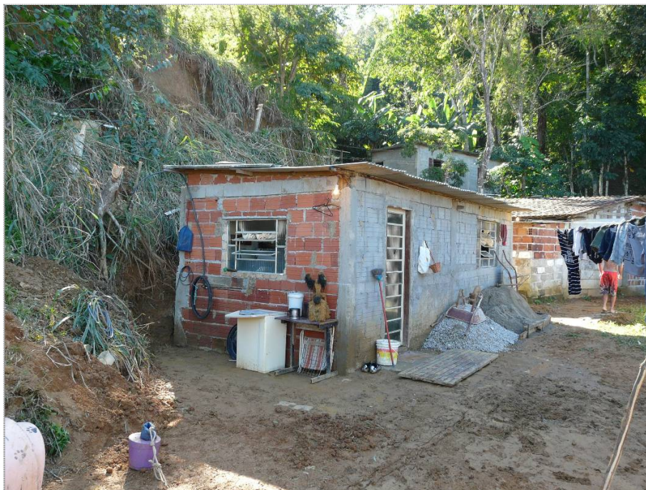
Foto CA-CL-01-01: Padrão de ocupação na base do talude de corte que apresenta processo de escorregamento em evolução.
