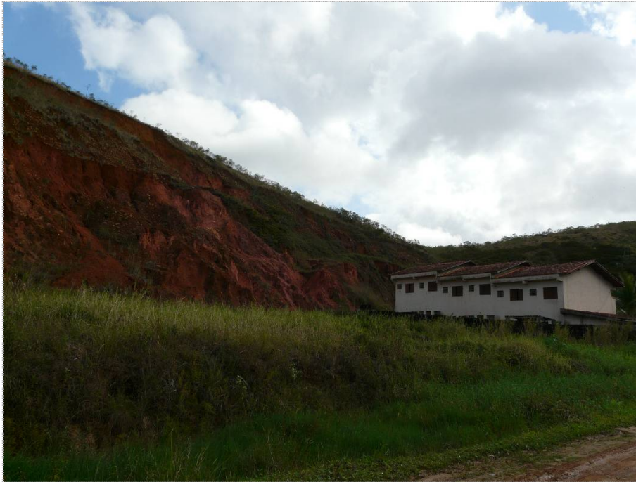
Foto CA-PR-03-01: Situação do talude de corte no setor. Notam-se feições de instabilidade como erosões e escorregamentos em evolução. Presença de surgência d'água no pé do talude.
