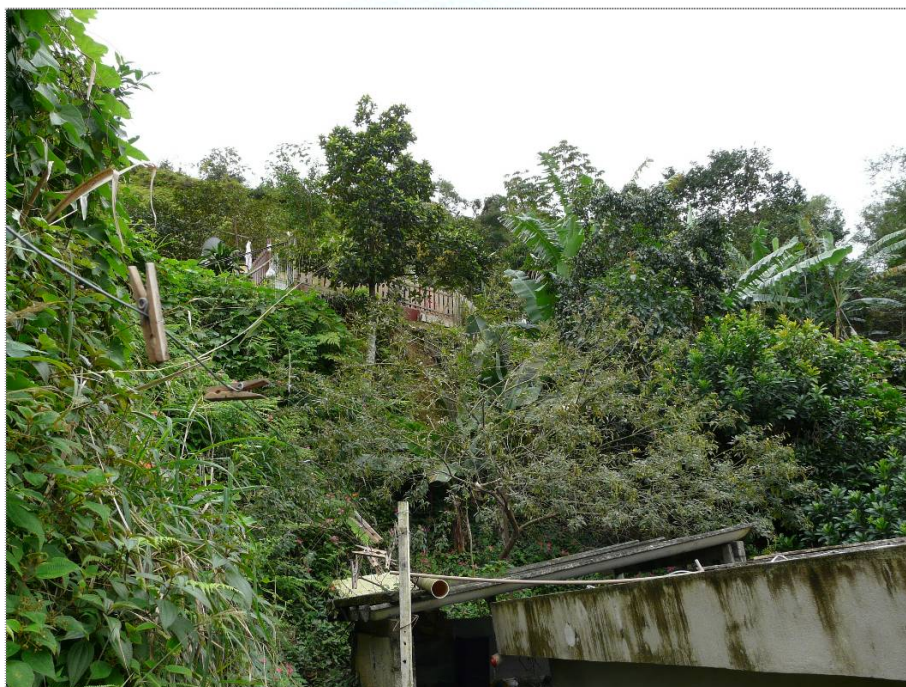
Foto CA-ED-01-02: Moradias próximas ao topo e à base do talude de corte. Observar concentração de águas servidas em superfície.
