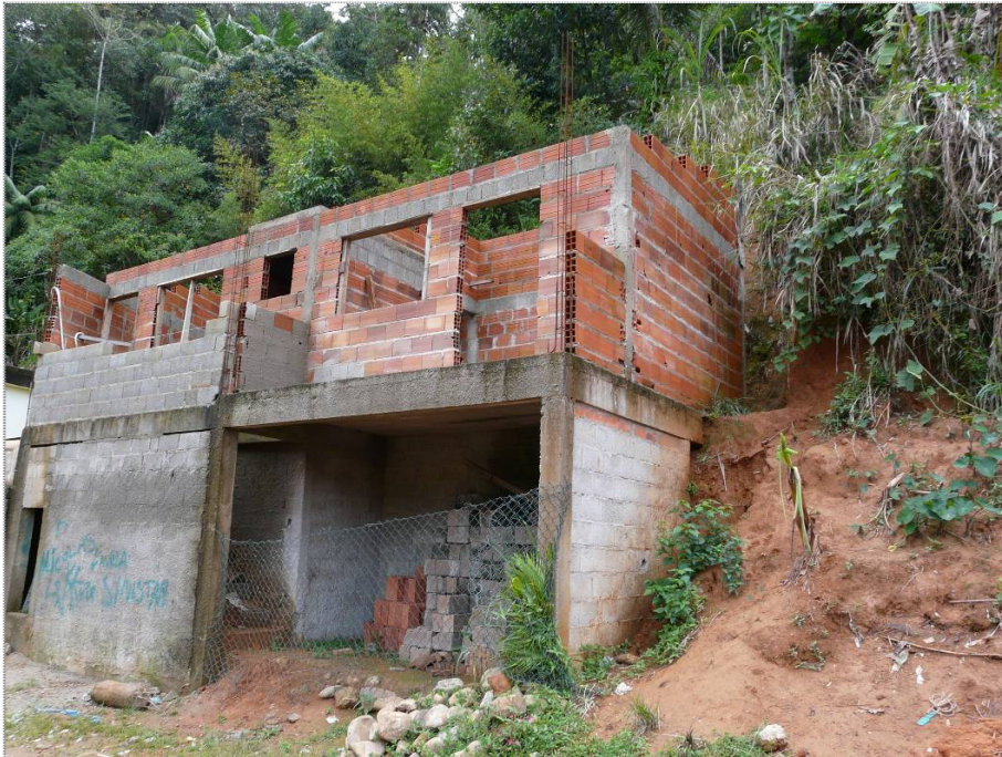
Foto CA-CG-03-01: Moradia em processo de construção. Observar a proximidade ao talude de corte.
