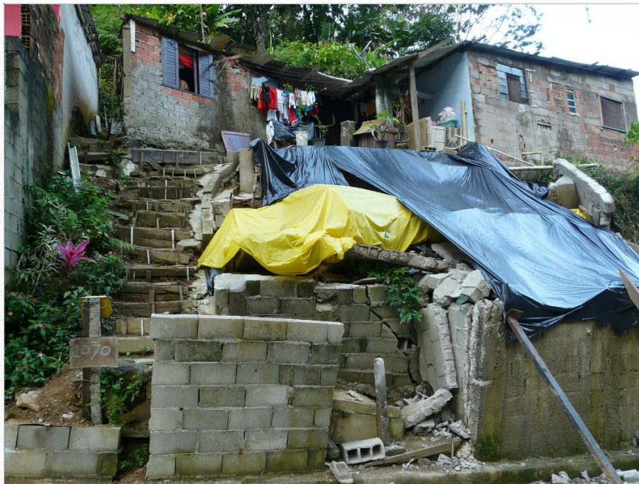
Foto CA-JA-01-01: Moradia cujo talude de corte sofreu escorregamento. Sugere-se a remoção da edificação.
