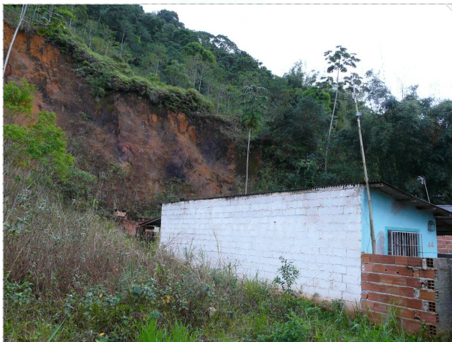
Foto CA-ST-01-02: Cicatriz de escorregamento em talude de corte, próximo aos fundos da moradia.
