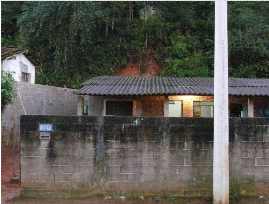
Foto CA-JA-03-01: Cicatriz de escorregamento em talude de corte, nos fundos da moradia.
