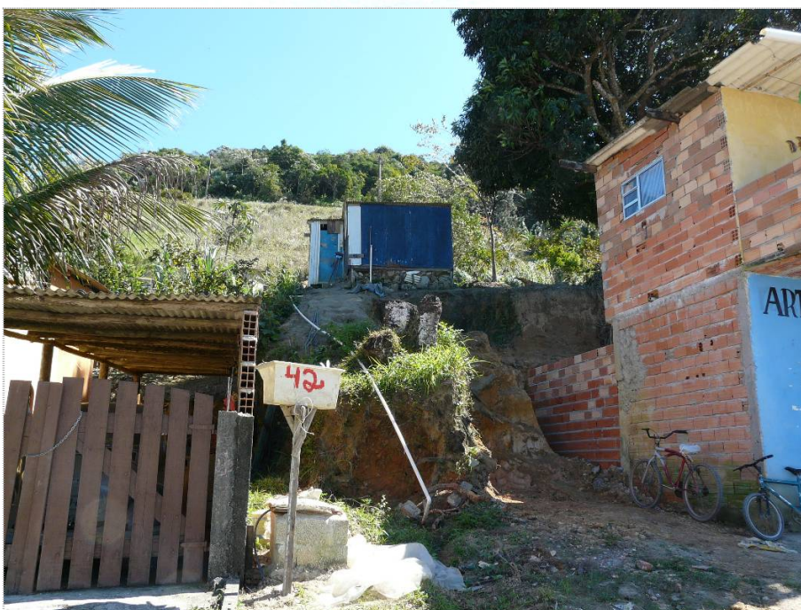
Foto CA-SR-02-02: Moradias próximas ao talude de corte, caracterizando situação de instabilização.
