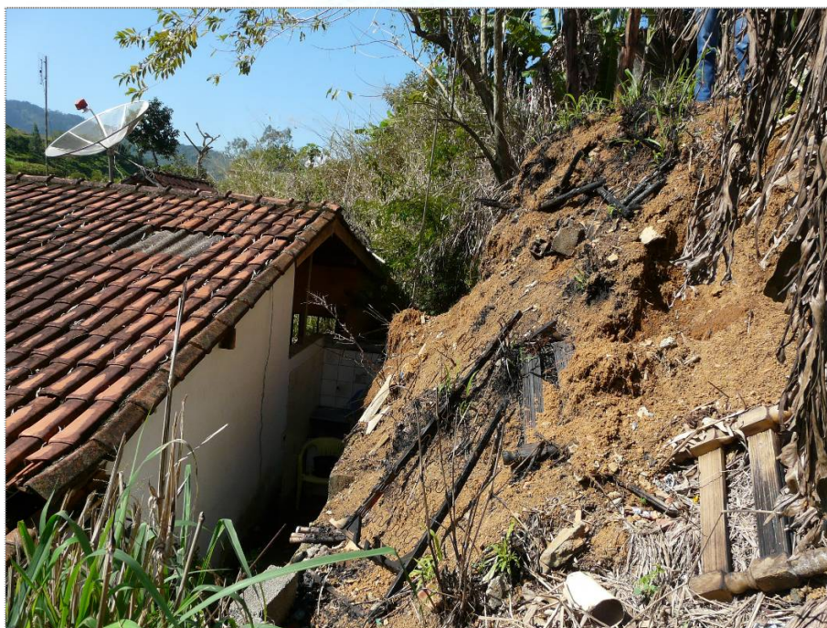
Foto CA-JA-04-02: Lixo, entulho e material desagregado com risco de escorregamento próximo à moradia.
