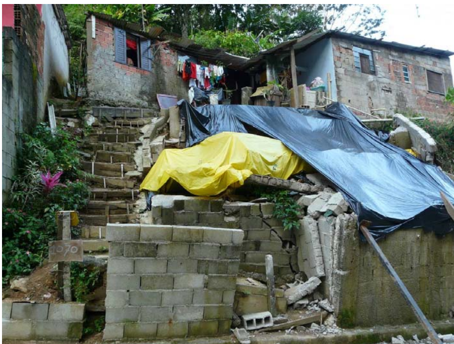
Foto 2 - Moradias a serem removidas localizadas no setor 1 da área do Jaraguazinho. Observar cicatriz de escorregamento, rompimento do muro, colocando em situação de muito alto risco esta moradia.
