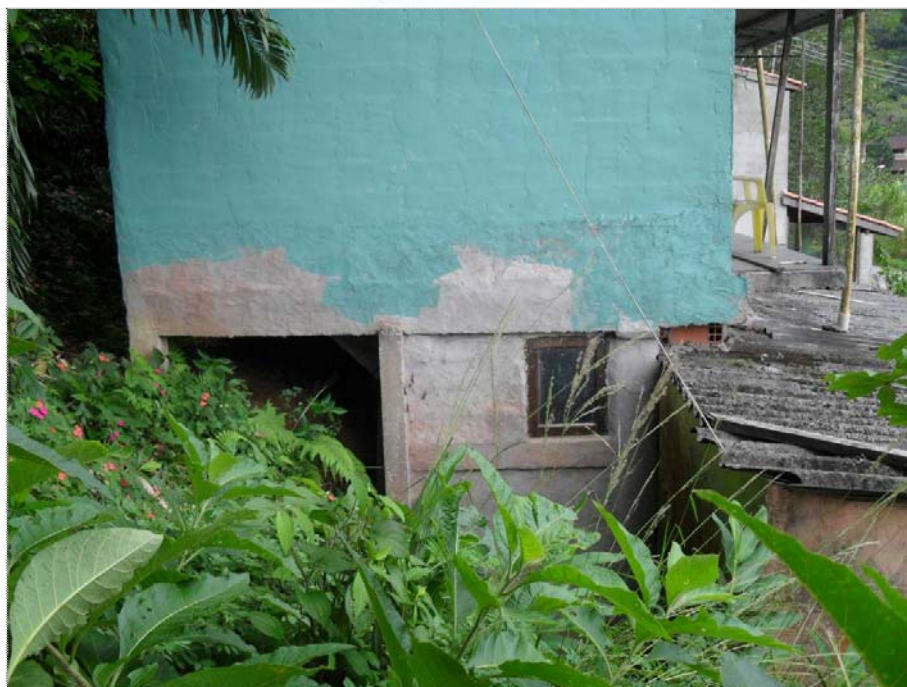
Foto CA-CO-01-02: Vista lateral do avanço da ocupação em patamares de corte. Presença de lixo, entulho e restos vegetais no topo do talude.
