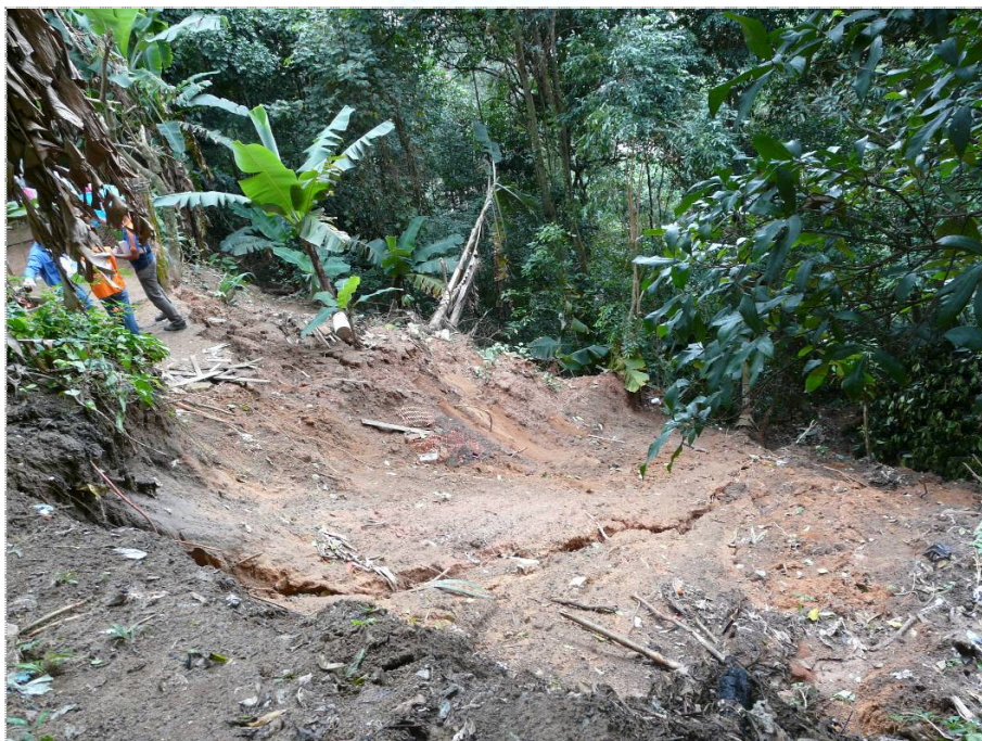
Foto CA-CB-01-02: Cicatriz de escorregamento em talude de corte. Nota-se a evolução do processo erosivo causado por concentração de escoamento superficial (águas pluviais e servidas), podendo ocasionar novos escorregamentos no local.
