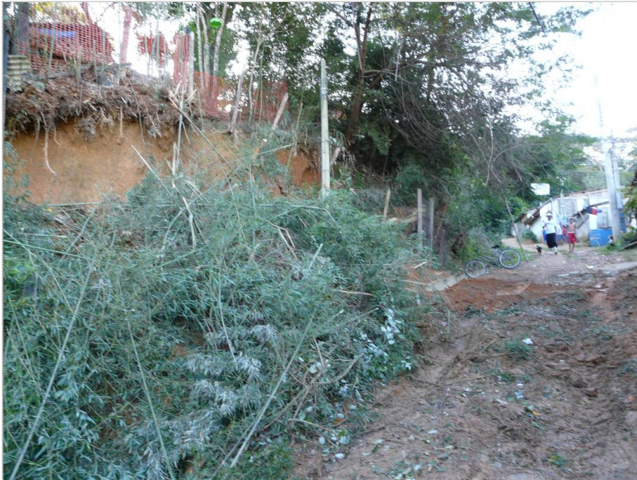
Foto CA-BE-01-01: Taludes de corte próximo à Rua Benedito José da Costa.
