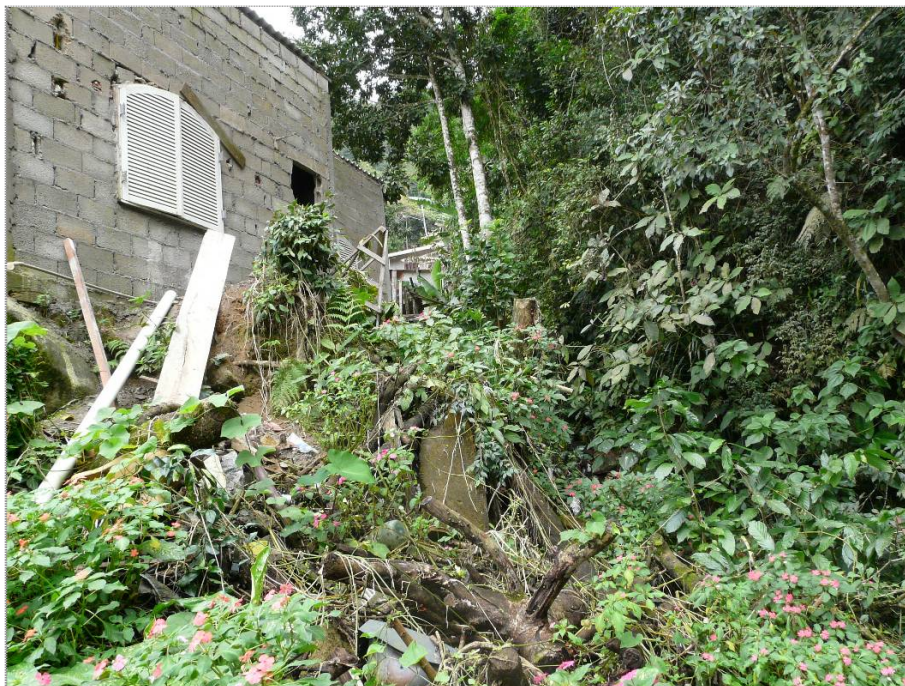
Foto CA-CB-04-01: Drenagem natural recebendo lançamentos de esgoto e águas servidas em superfície, bem como lixo, entulho e restos vegetais, além da presença de bananeiras no leito do canal. Sugere-se a limpeza, desassoreamento da drenagem e canalização do esgoto.
