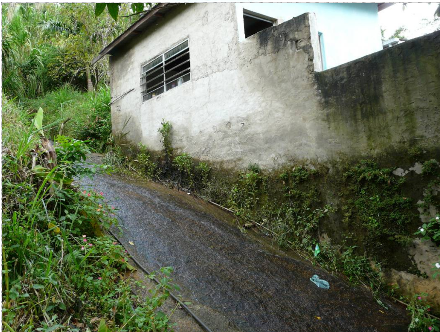
Foto CA-OL-06-02: Drenagem da rodovia escoando na base da moradia, sem proteção lateral nem canaletas para orientar o fluxo. Há o risco de comprometimento da estrutura da edificação, além da umidade, observada pelas manchas na parede.
