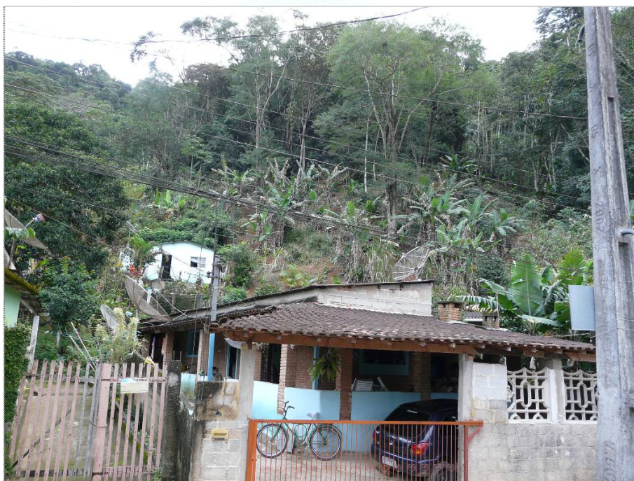
Foto CA-CG-01-02: Situação da encosta natural com solo exposto e plantio de bananeiras, em alta declividade, conferindo o grau de risco alto às moradias do entorno.
