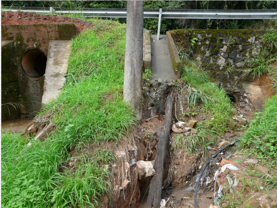
Foto CA-OL-06-01: Sistema de águas pluviais da rodovia, a montante das moradias. Notar o entupimento das tubulações e acúmulo de lixo no talude, causando sua instabilização (processo erosivo).
