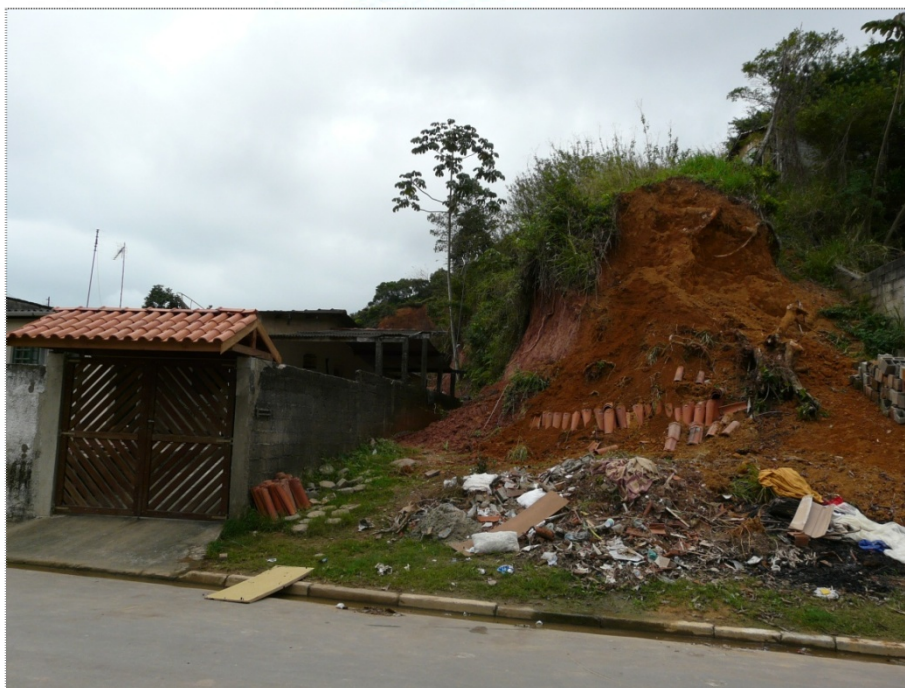
Foto CA-CB-08-02: Proximidade da moradia em relação ao talude de corte. Nota-se a deposição de lixo e entulho e a exposição do solo.
