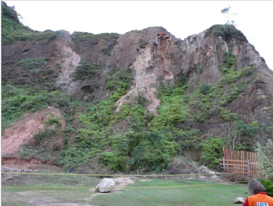
Foto CA-CJ-01-01: Talude de corte com rolamento de blocos, erosão e escorregamentos dentro da área comum do condomínio. Sugere-se a execução de muro de espera do material movimentado, bem como para orientação do escoamento superficial.
