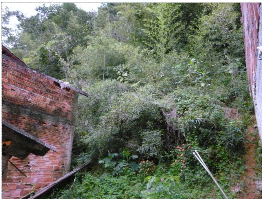
Foto CA-PF-01-02: Notar a proximidade da ocupação em relação à encosta natural.
