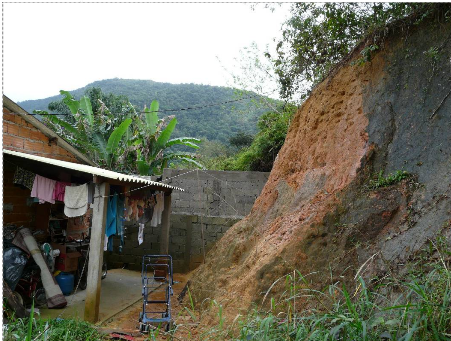
Foto CA-OL-05-01: Proximidade do talude de corte em relação à moradia no setor. Observar cicatriz de escorregamento.
