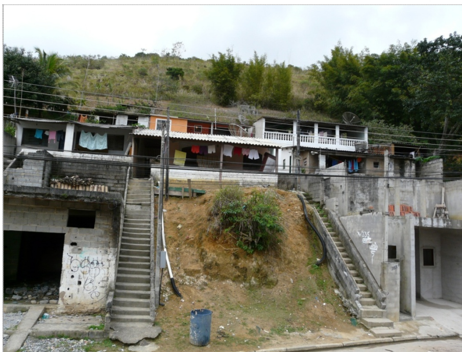
Foto CA-CB-08-01: Padrão de ocupação do setor. Observar proximidade das moradias em relação ao topo e à base do talude de corte.
