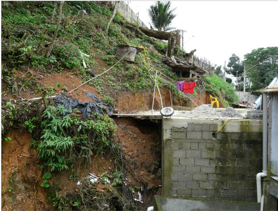
Foto CA-CB-03-03: Cicatriz de escorregamento em talude de corte atingindo os fundos das moradias. Sugerem-se obras de contenção, limpeza e proteção superficial nestes taludes.
