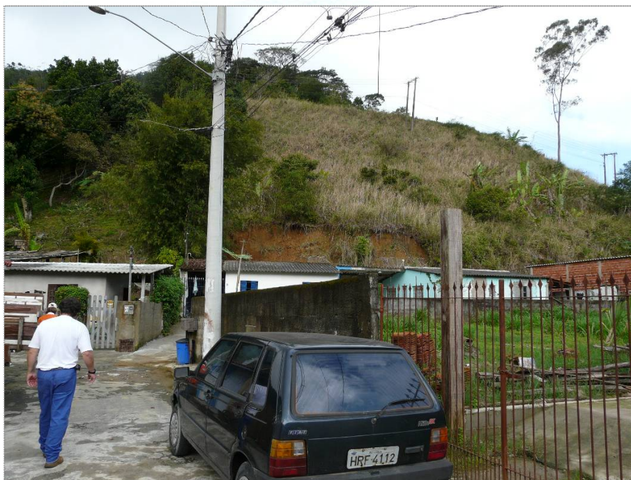
Foto CA-OL-06-04: Processo de escorregamento no talude de corte. O morador executou muro de contenção de flexão em concreto armado, mas de altura insuficiente para conter o movimento do material para o quintal da moradia.
