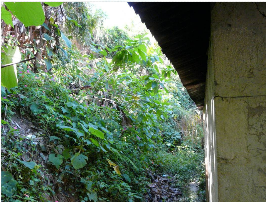
Foto CA-JA-07-02: Moradia muito próxima ao talude de corte, com presença de vegetação rasteira.
