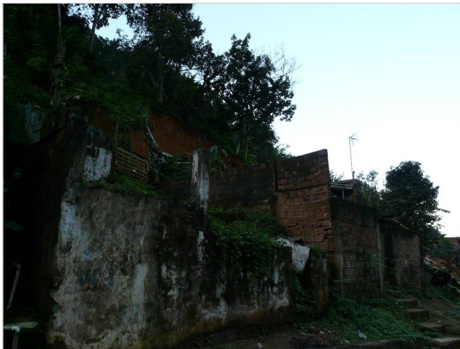
Foto CA-JA-01-03: Cicatriz de escorregamento em talude de corte. Material remobilizado atingiu as moradias da base.
