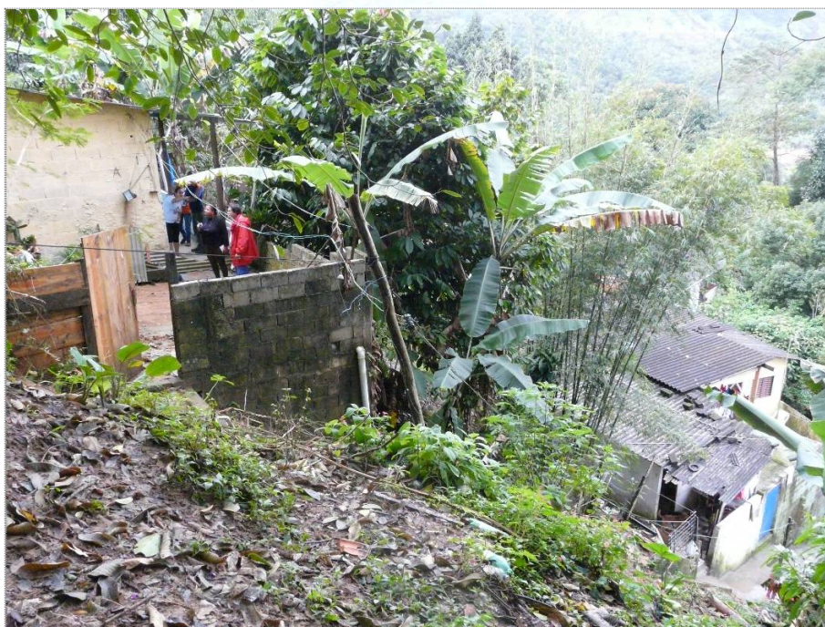
Foto CA-OL-03-04: Na parte superior, moradia atingida pelo escorregamento. O muro de divisa apresenta trincas e sinais de instabilidade pela sobrecarga do escoamento superficial e pode atingir moradia situada na parte inferior.
