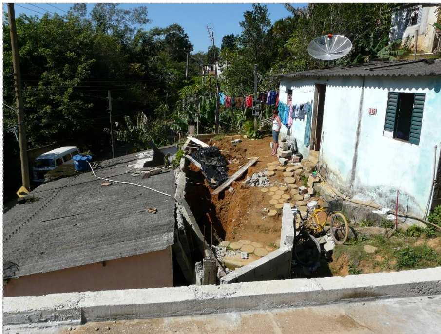
Foto CA-JA-04-01: Escorregamento em talude de corte/aterro atingiu os fundos da moradia
