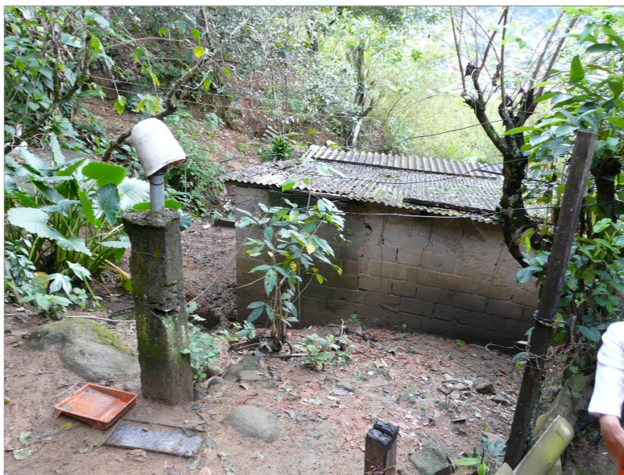
Foto CA-OL-07-02: Padrão de ocupação da encosta. Falta sistema de drenagem e acesso às moradias. Notar que a moradia em questão encontra-se na linha da concentração do escoamento superficial.
