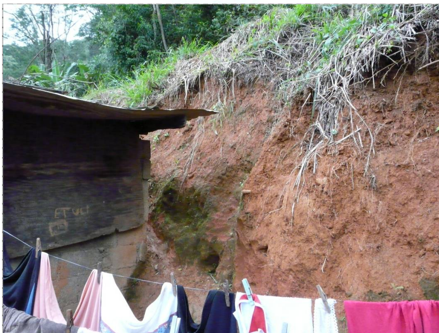
Foto CA-CG-02-02: Proximidade da moradia ao talude de corte com cicatriz de escorregamento. Executar remoção da moradia.
